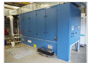
Aktuell installierte BHKWs
