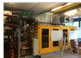
Montage neues BHKW 1
