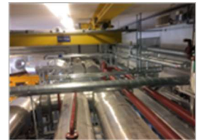
Gesamtanlage von oben
