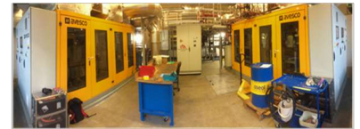
Gesamtanlage mit Wärmepumpe
